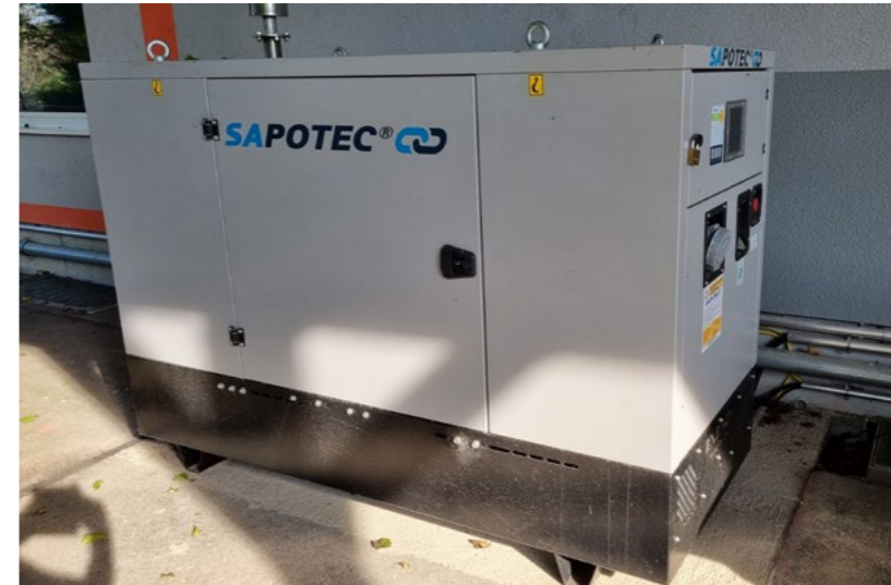
Abb. 11.106: Ein 30 kVA Notstromaggregat sorgt als Netzersatzanlage seit 2022 für Stromausfallsicherheit im Rüsthaus
