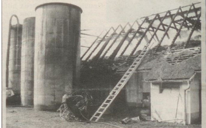
Insgesamt wurden vier Brände seit Ende August in Eibiswald „gelegt“. Schaden ca. 12 Millionen. Foto: Krainer
