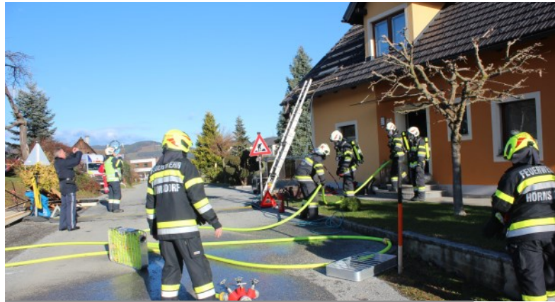
Der Dachstuhl sollte an diesem Tag eigentlich repariert werden
